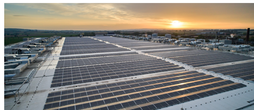
Fotovoltaika na střechách budov
